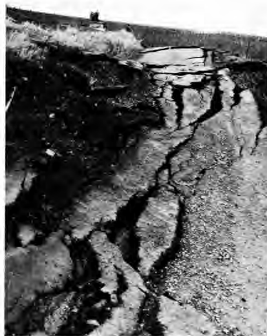
Abbildung 7 Hangrutsch bei Ober-Olm Aufnahme 6. 2. 1982
